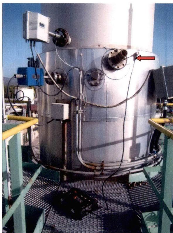
Foto 5: Punto di prelievo dei fumi (freccia rossa)
