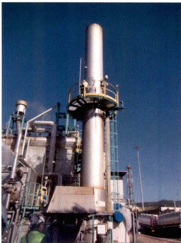
Foto 9: Punto di emissione E12c
