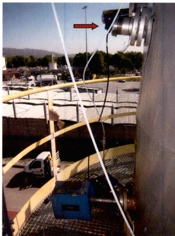
Foto 10: Punto di prelievo dei fumi (freccia rossa)
