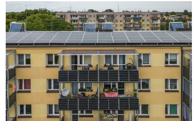
GSHP nell'edilizia sociale - Szcztyno, Polonia
