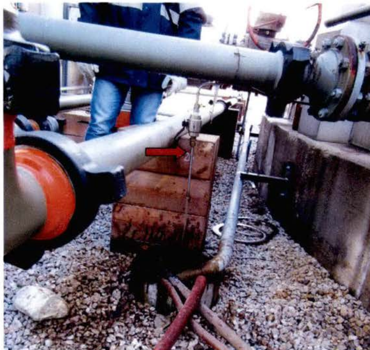
Foto 2 – Punto di campionamento reflui da serbatoio di stoccaggio V560-TA-002 (freccia di colore rosso)
