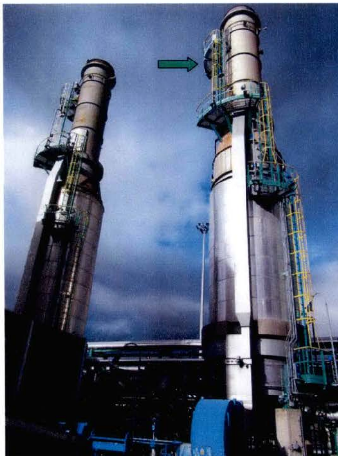
Foto 14: Punto di emissione E04 bis (camino indicato dalla freccia di colore verde)
