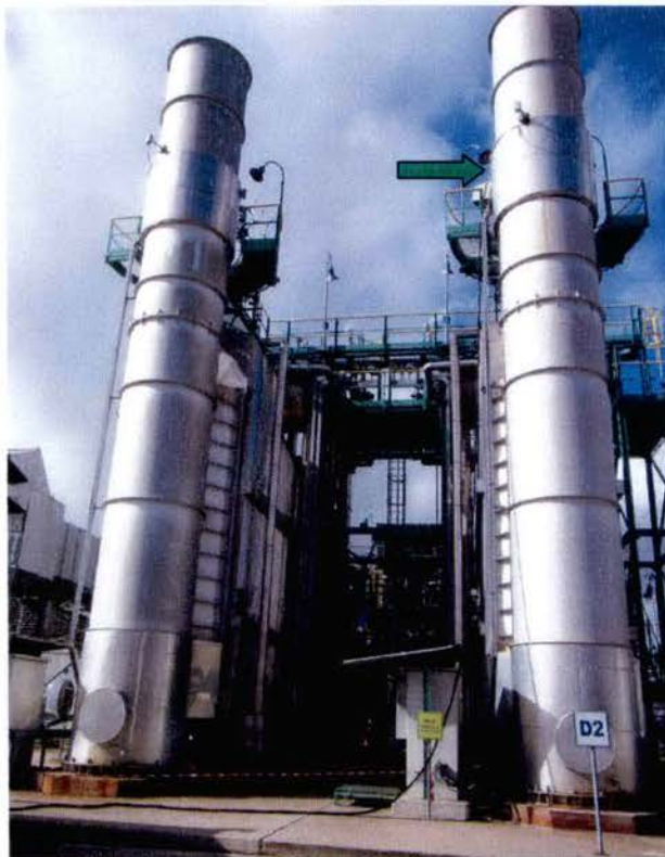
Foto 6: Punto di emissione E11b (camino indicato dalla freccia di colore verde)
