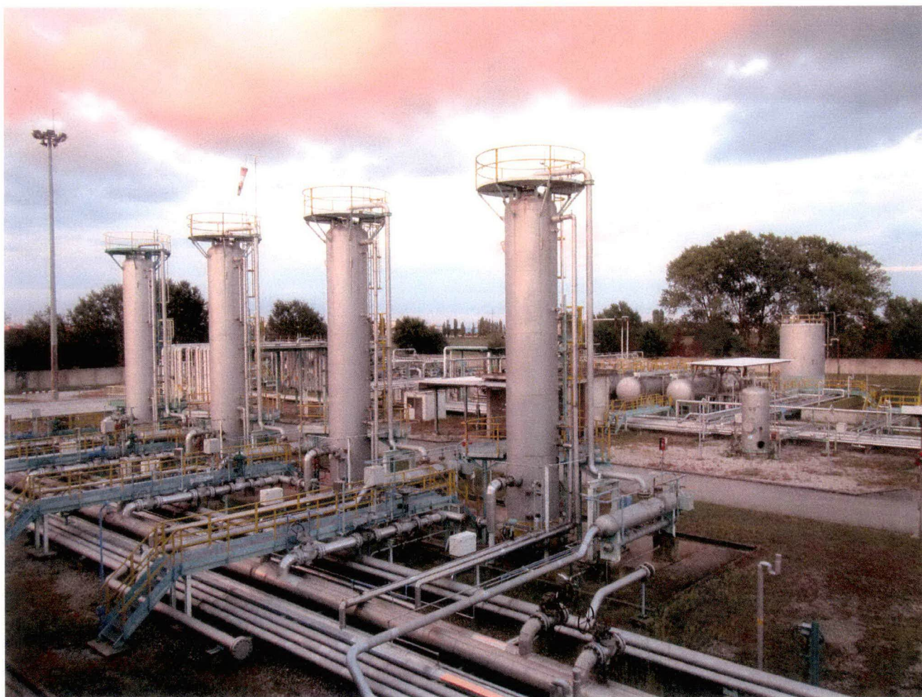
Centrale “Ravenna Mare”
