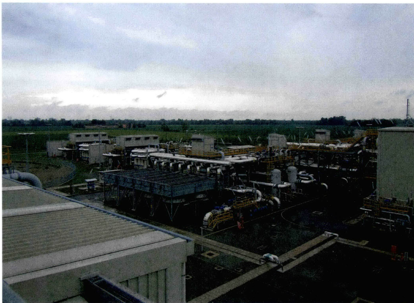
Centrale “Bordolano stoccaggio”
