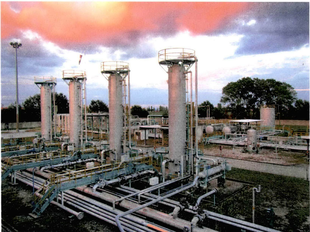
Centrale “Ravenna Mare”
