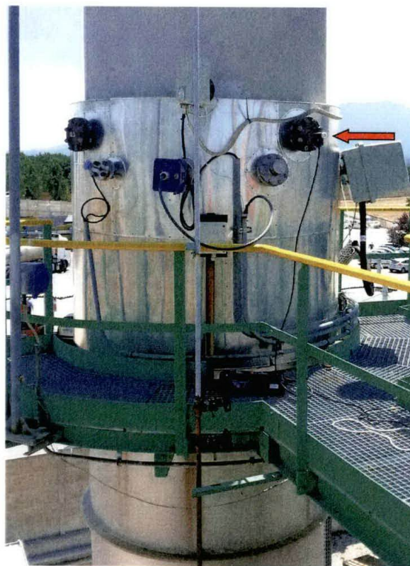
Foto 10: Punto di prelievo dei fumi (freccia rossa)
