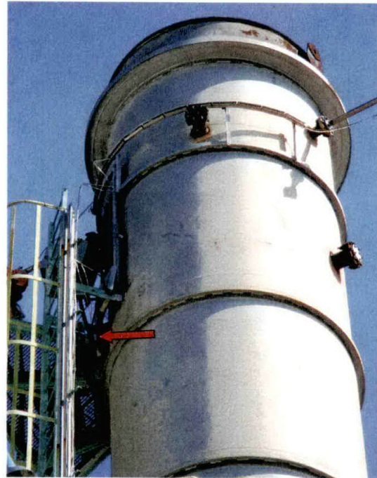
Foto 24: Punto di prelievo dei fumi (freccia rossa)
