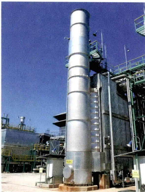
Foto 11: Punto di emissione E11c
