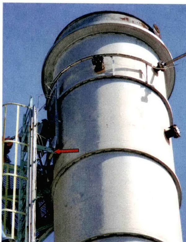
Foto 22: Punto di prelievo dei fumi (freccia rossa)
