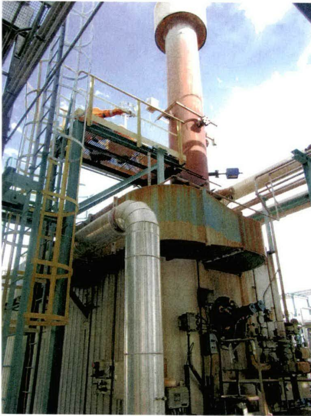
Foto 18: Punto di emissione E03
