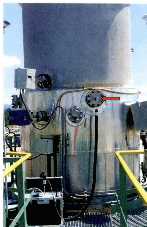
Foto 12: Punto di prelievo dei fumi (freccia rossa)
