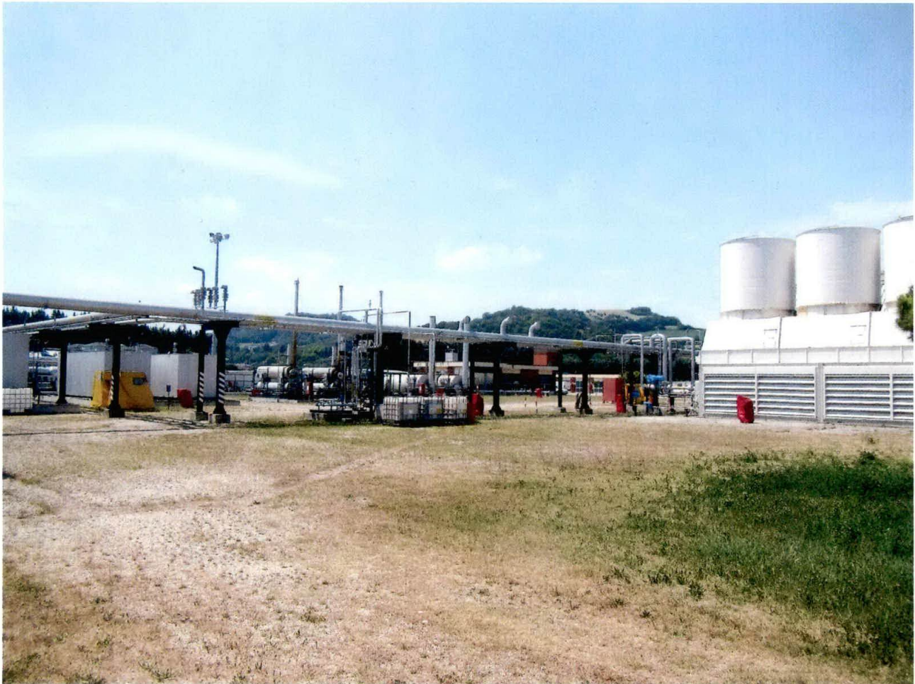
Centrale “San Giorgio Mare”
