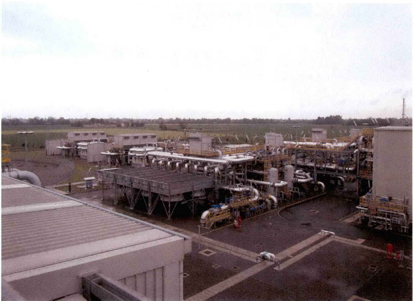
Centrale “Bordolano stoccaggio”
