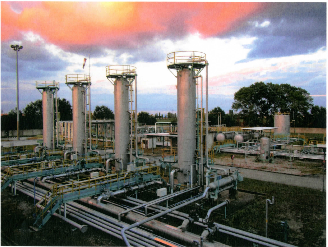
Centrale “Ravenna Mare”
