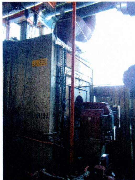
Foto 5 - Caldaia a gasolio FA101A
