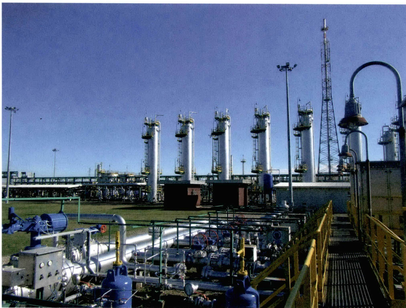
Centrale “Settala stoccaggio”
