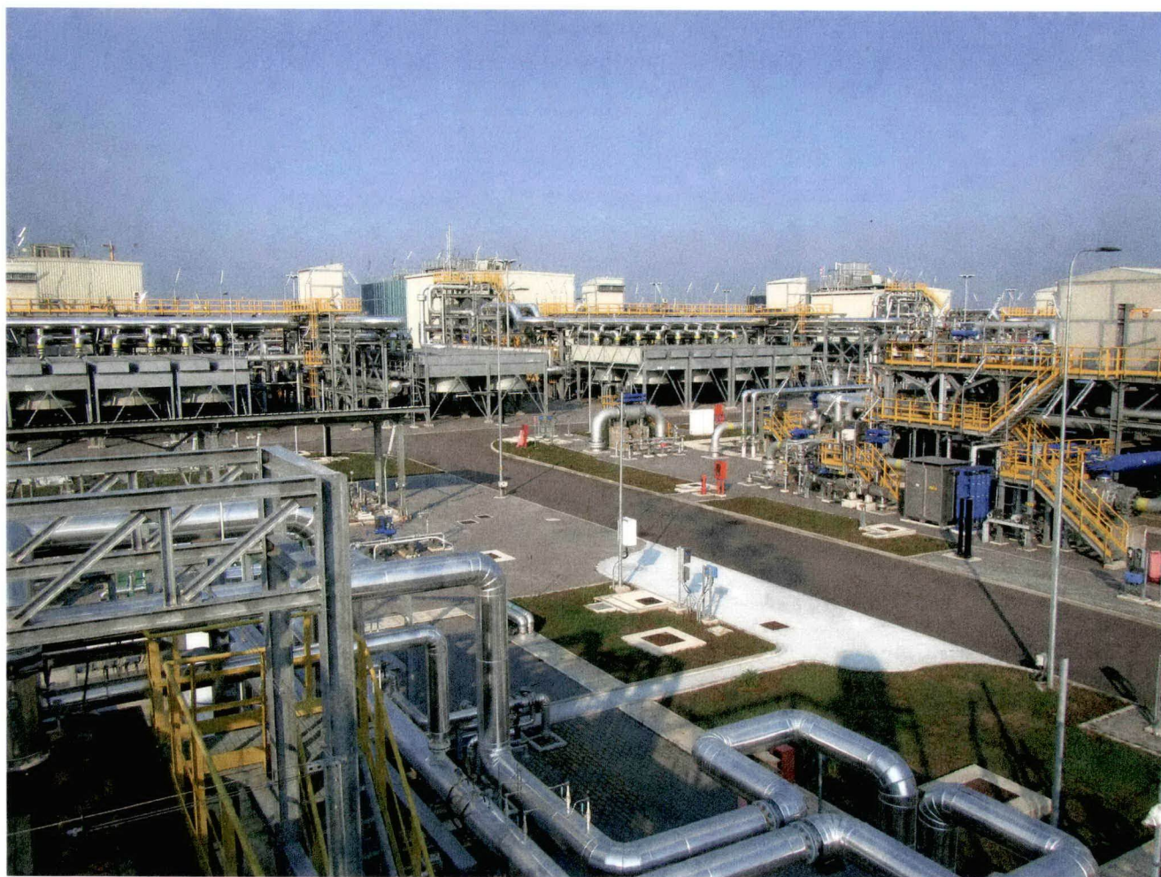
Centrale “Bordolano stoccaggio”
