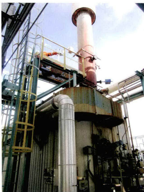
Foto 21: Punto di emissione E03
