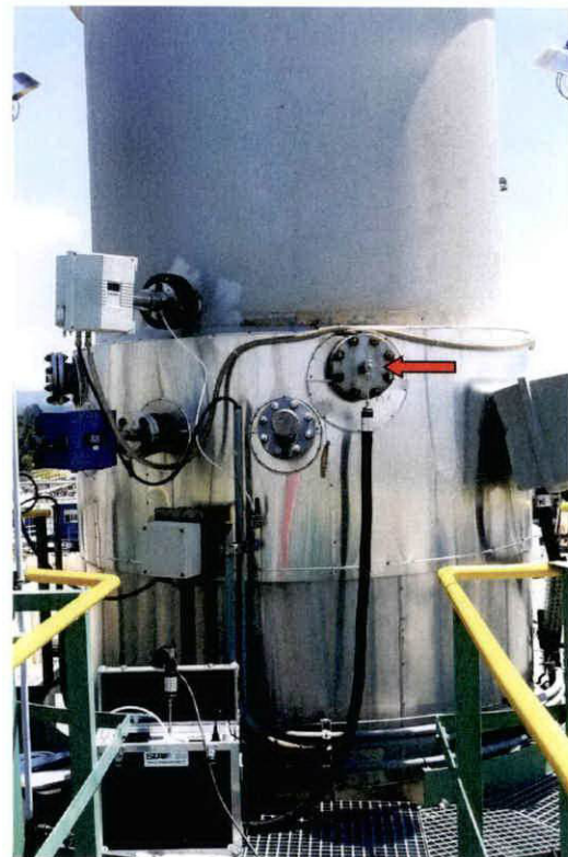
Foto 14: Punto di prelievo dei fumi (freccia rossa)
