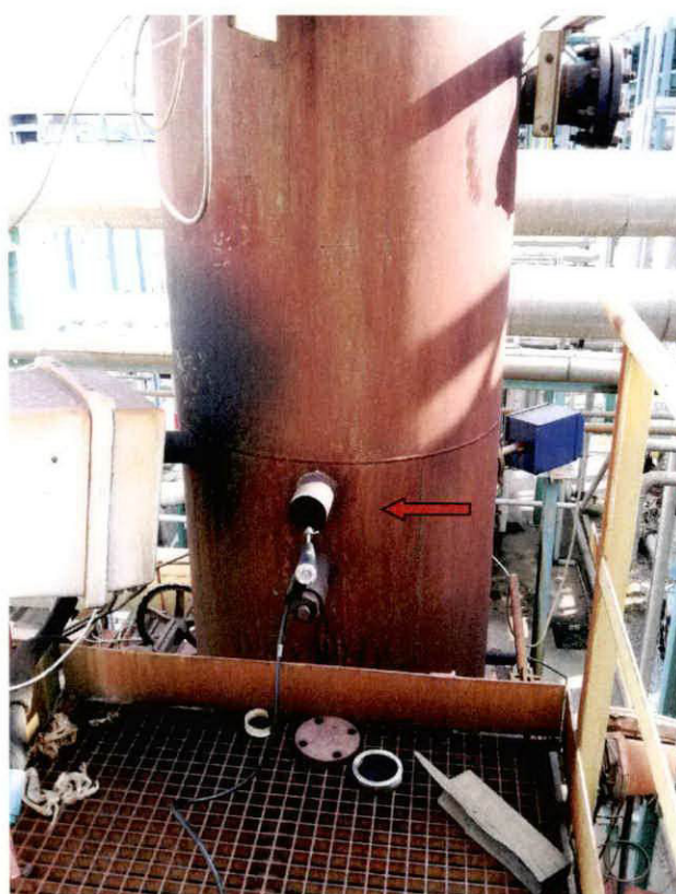
Foto 22: Punto di prelievo dei fumi (freccia rossa)
