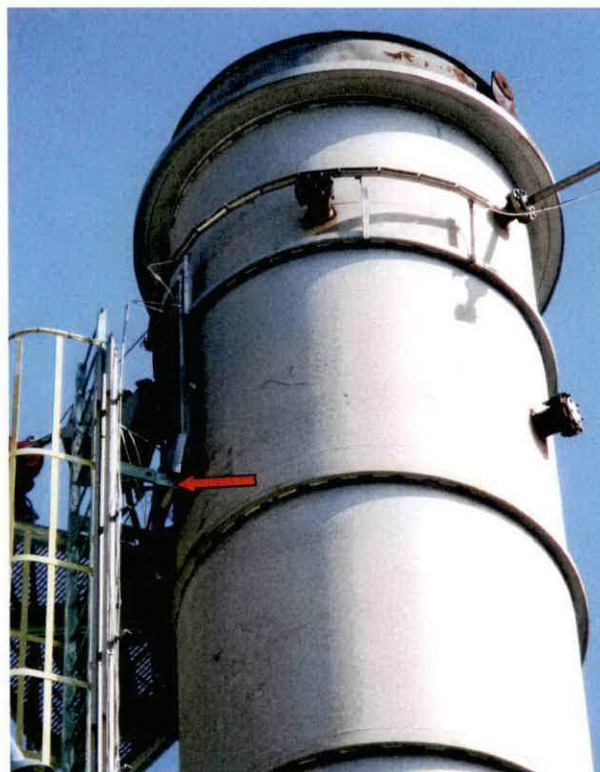
Foto 10: Punto di prelievo dei fumi (freccia rossa)
