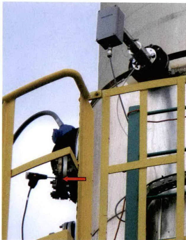
Foto 18: Punto di prelievo dei fumi (freccia rossa)
