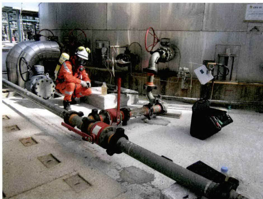
Foto 2 – Campionamento reflui da serbatoio di stoccaggio V560-TA-002
