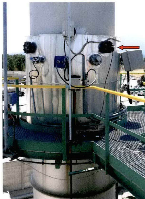
Foto 12: Punto di prelievo dei fumi (freccia rossa)
