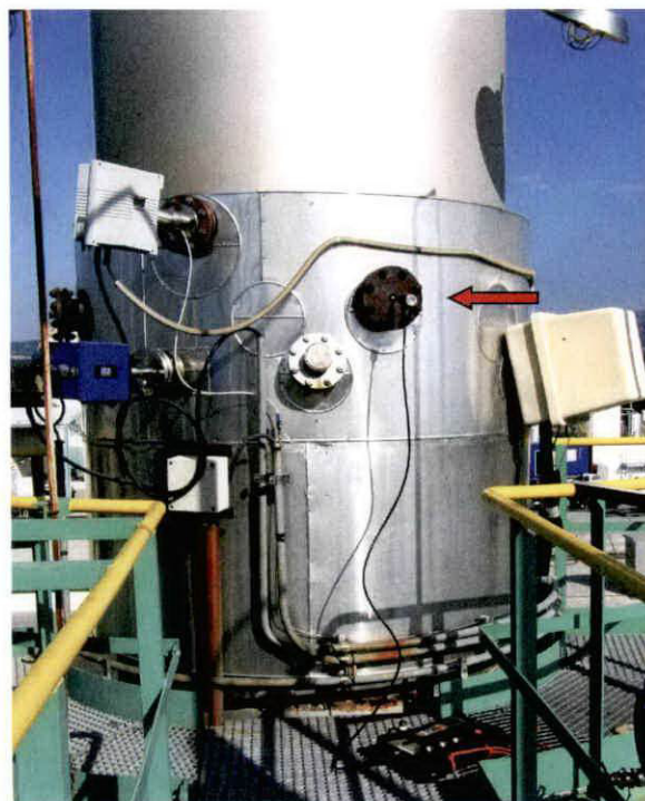
Foto 8: Punto di prelievo dei fumi (freccia rossa)
