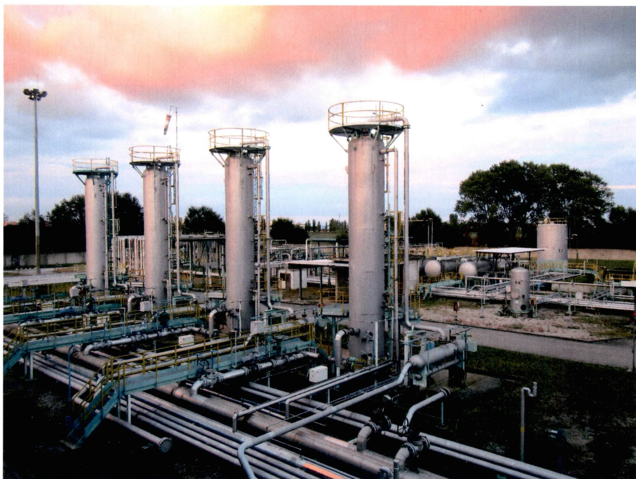
Centrale “Ravenna Mare”
