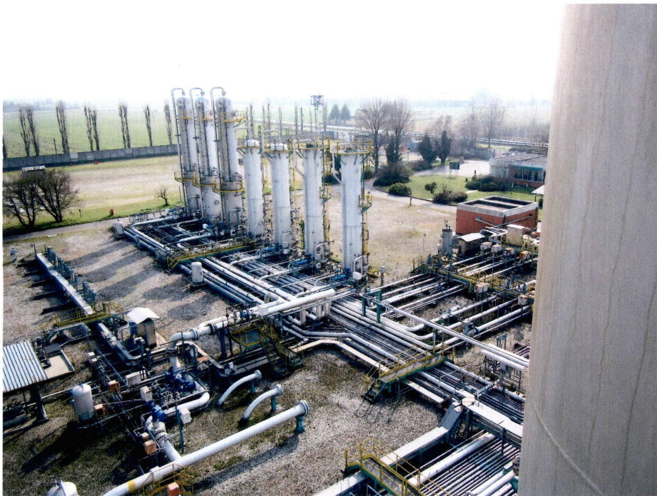
Centrale di stoccaggio “Ripalta stoccaggio”
