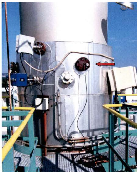
Foto 8: Punto di prelievo dei fumi (freccia rossa)
