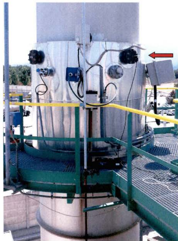
Foto 12: Punto di prelievo dei fumi (freccia rossa)
