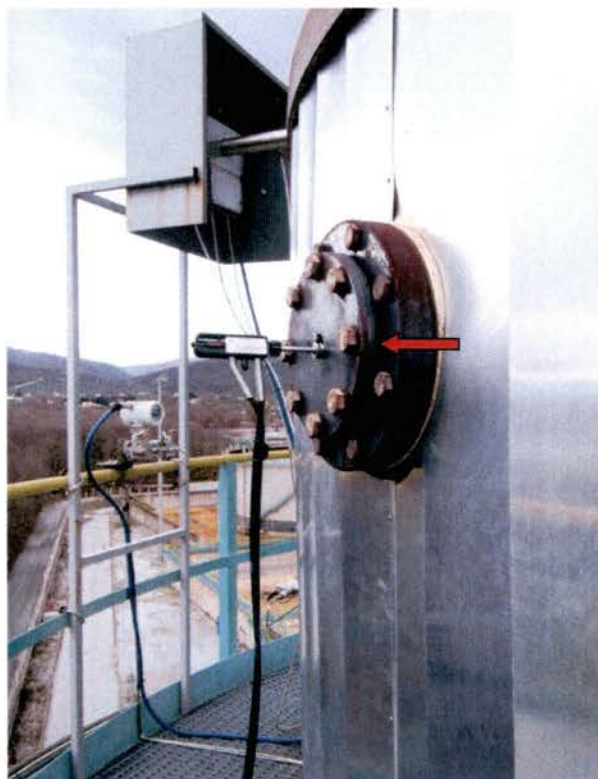
Foto 20: Punto di prelievo dei fumi (freccia rossa)
