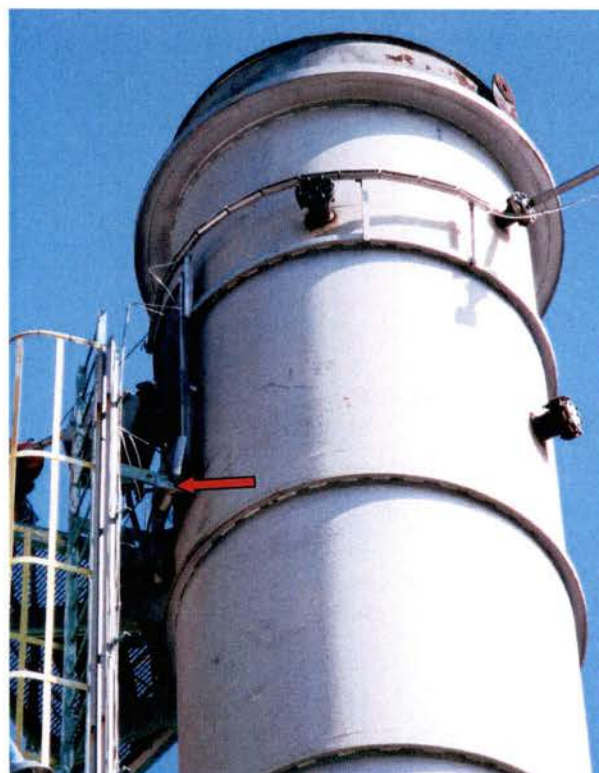
Foto 10: Punto di prelievo dei fumi (freccia rossa)
