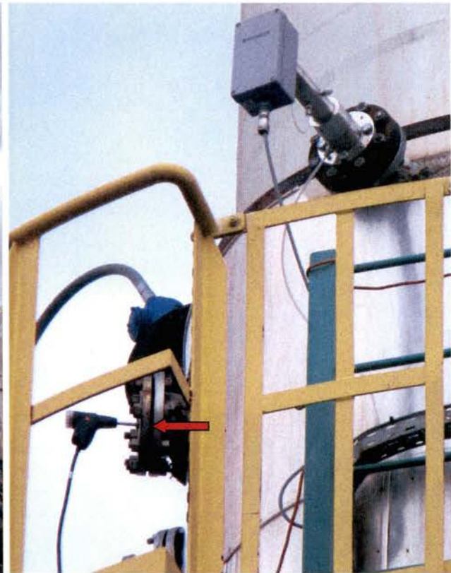
Foto 18: Punto di prelievo dei fumi (freccia rossa)
