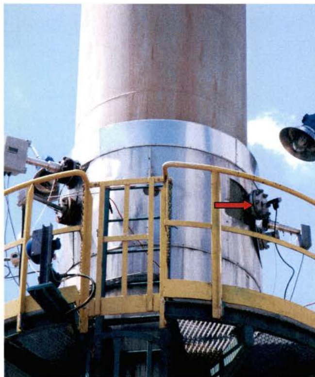
Foto 16: Punto di prelievo dei fumi (freccia rossa)
