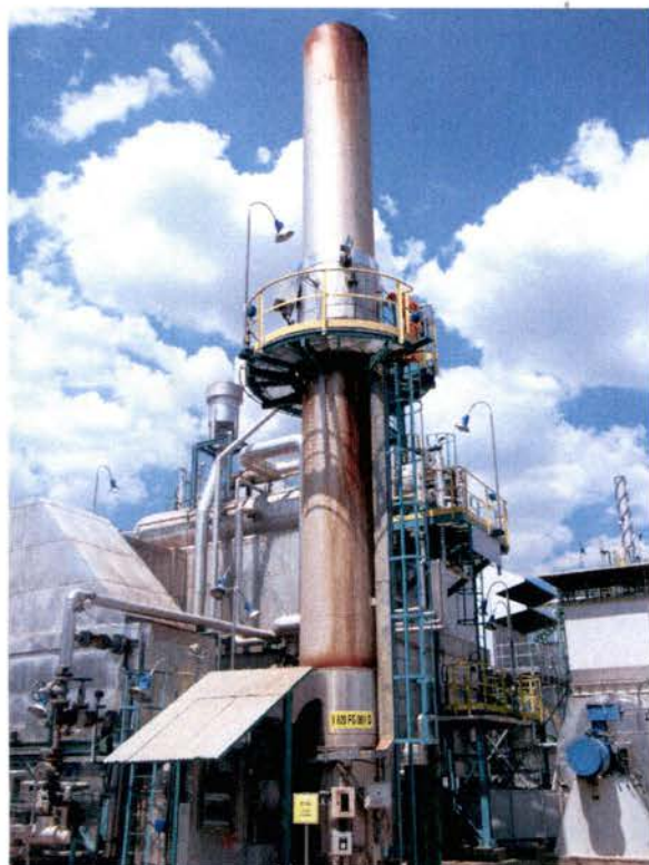
Foto 15: Punto di emissione E12c
