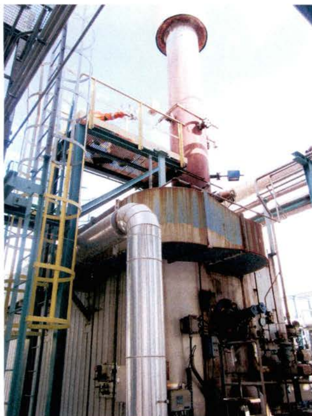
Foto 21: Punto di emissione E03
