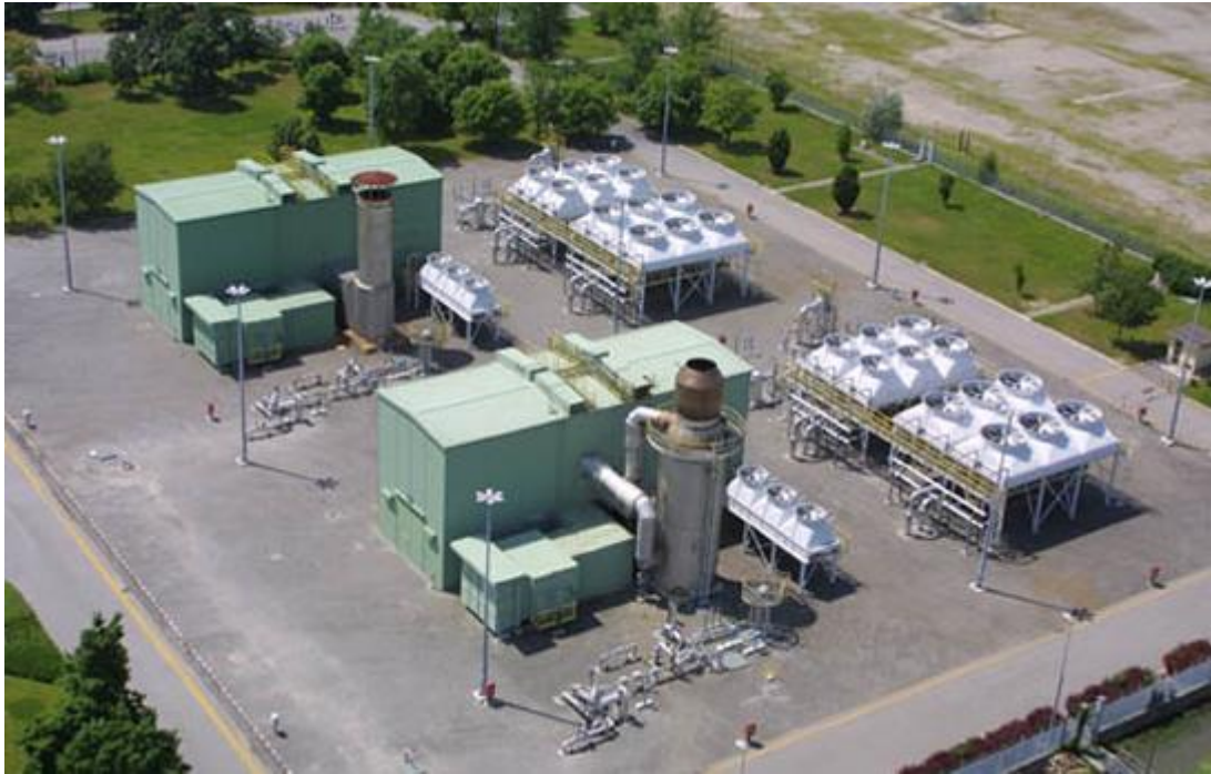
Fig. 7 Centrale di compressione – Cabinati turbocompressori, tubazioni e refrigeranti
