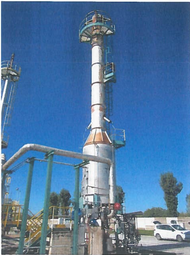
Foto 2: Punto di emissione E5 – Termodistruttore
