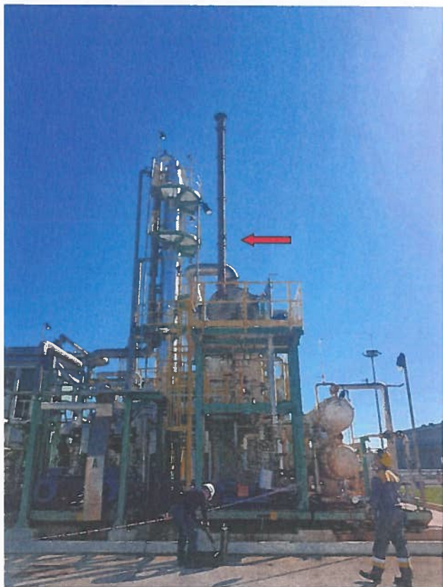
Foto 4: Punto di emissione E2 – Rigeneratore DEG
