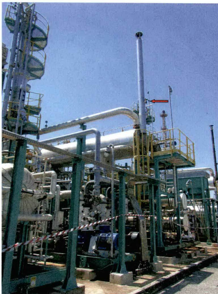
Foto 2 - Rigeneratore glicol con punto di prelievo (freccia rossa)
