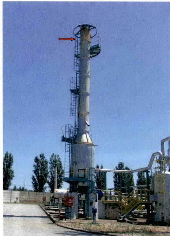
Foto 1- Termodistruttore con punto di prelievo (freccia rossa)
