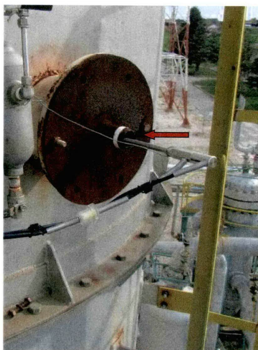
Foto 3: Punto di prelievo dei fumi (freccia rossa)
