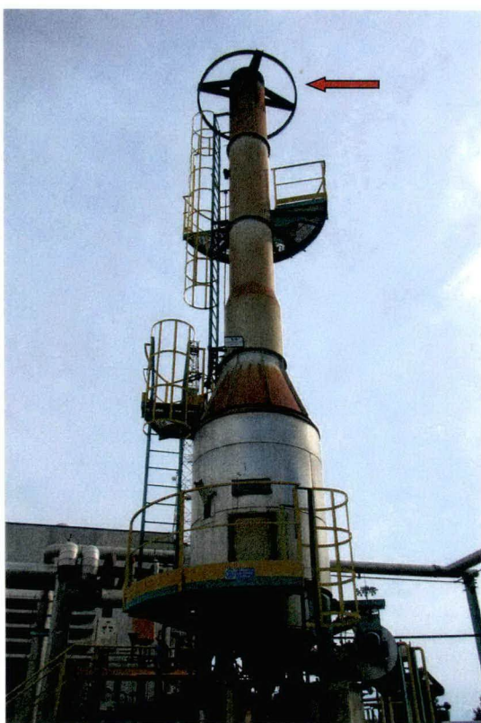
Foto 4: Punto di emissione E6 (freccia rossa)
