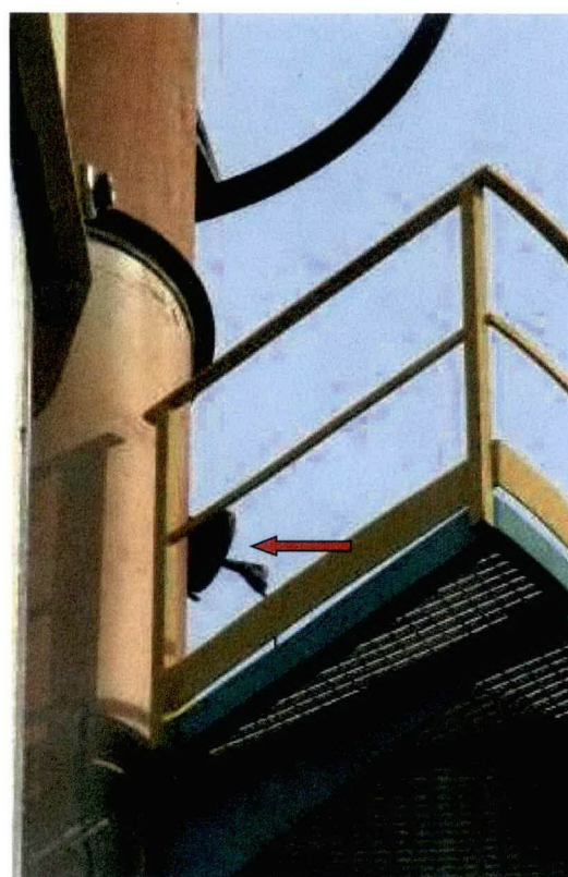
Foto 5: Punto di prelievo dei fumi (freccia rossa)
