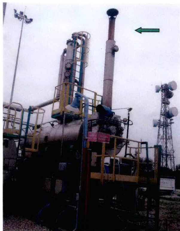
Rigeneratore RG-1 e punto di emissione E3 (freccia verde)
