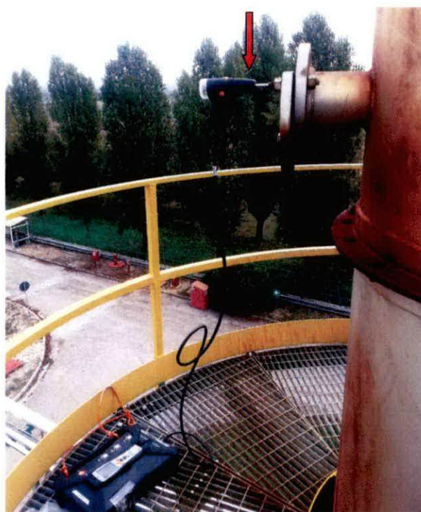
Punto di prelievo dei fumi (freccia rossa)
