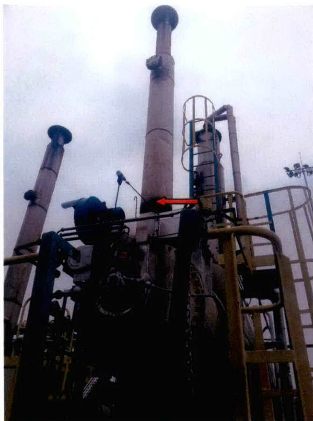
Punto di prelievo dei fumi (freccia rossa)
