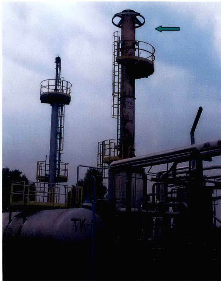
Termodistruttore F-1 e punto di emissione E1 (freccia verde)
