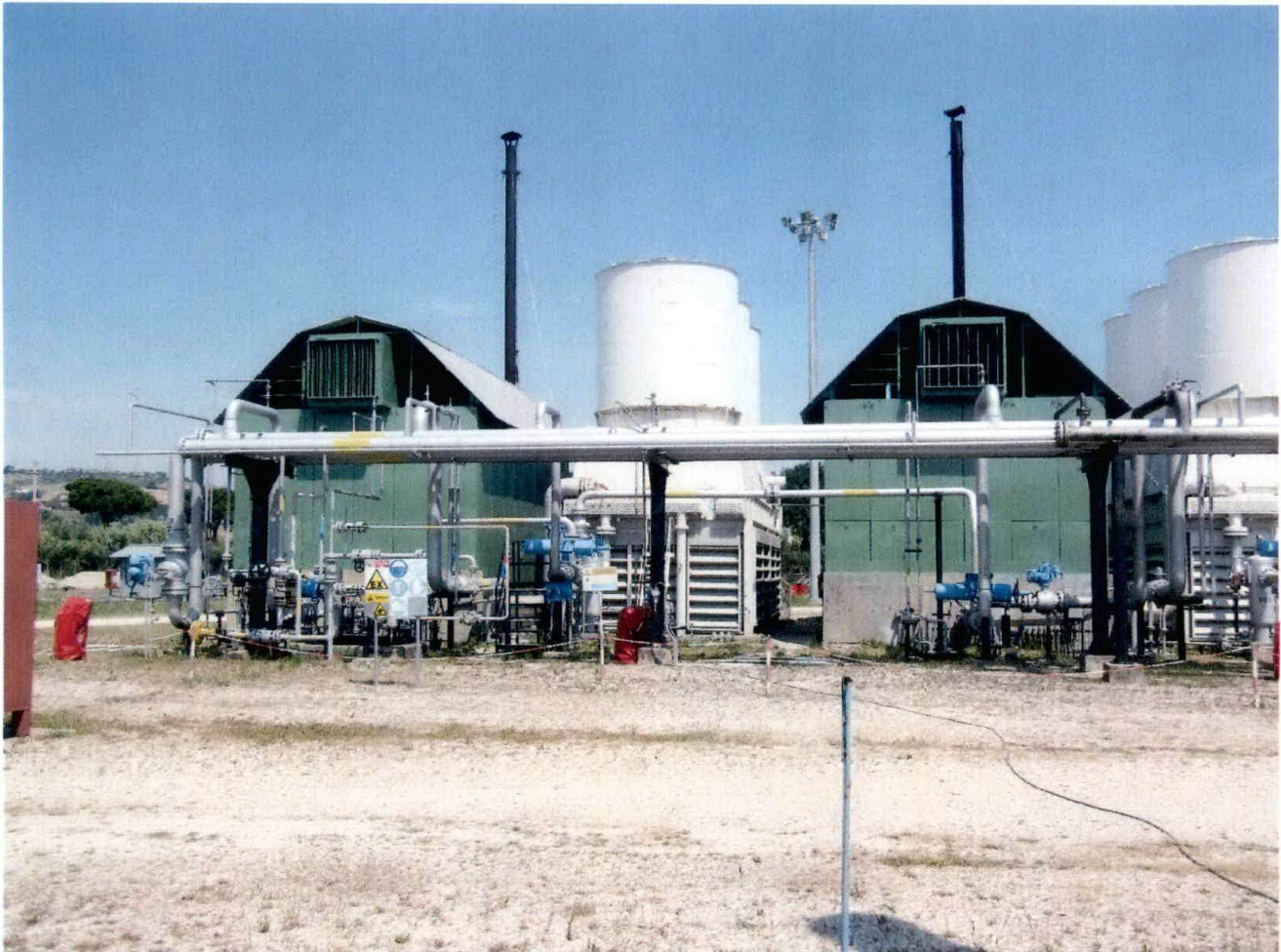
Centrale “San Giorgio Mare”
