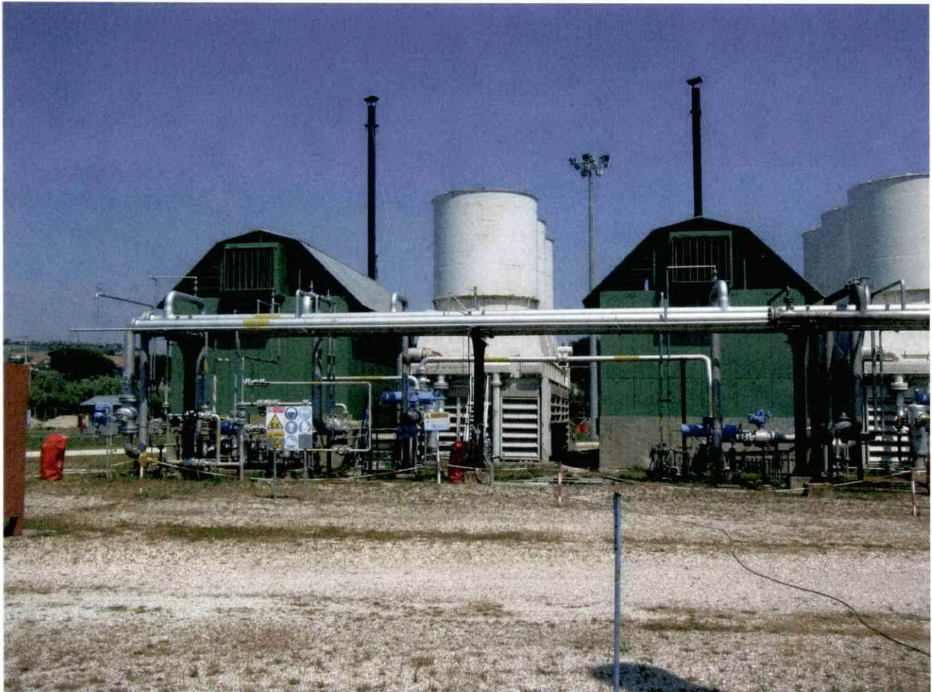
Centrale “San Giorgio Mare”: Motocompressori K101 e K201
