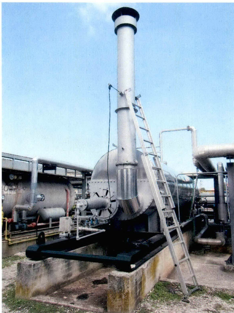
Centrale “Maria a Mare” – riscaldatore acqua/olio
