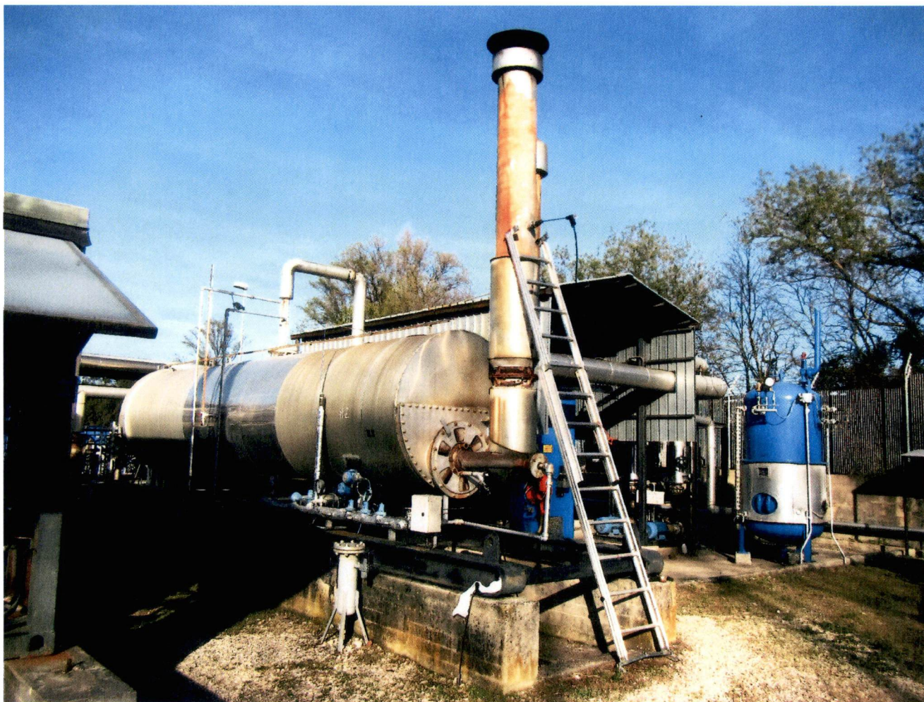
Centrale “Maria a Mare” – riscaldatore acqua/olio
