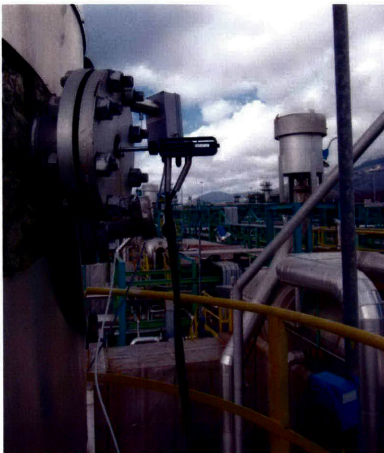
Foto 2 - Punto di emissione E12c- flangia di campionamento con sonda di prelievo
