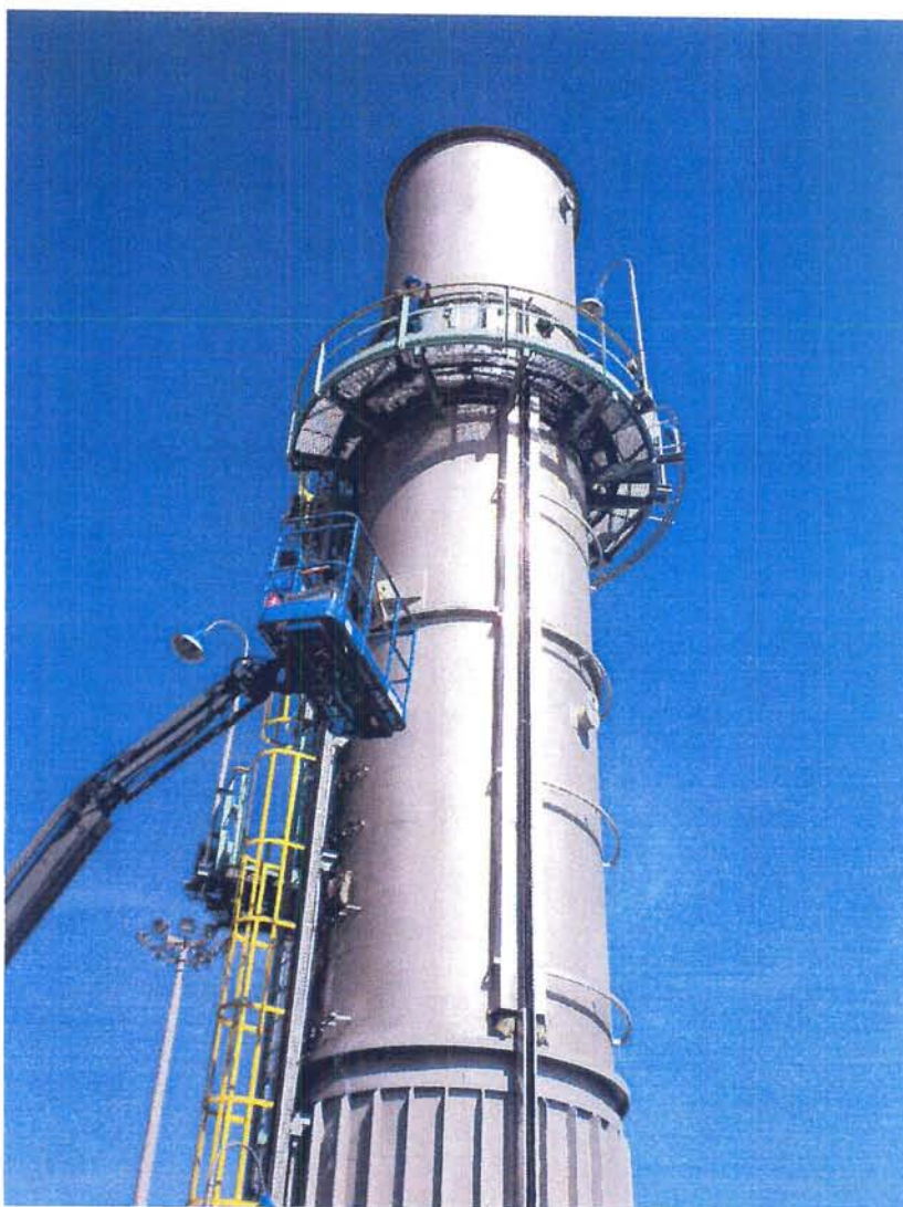
Fig. 1 - Camino del termodistruttore V580-FJ-951, punto di emissione "E20"
