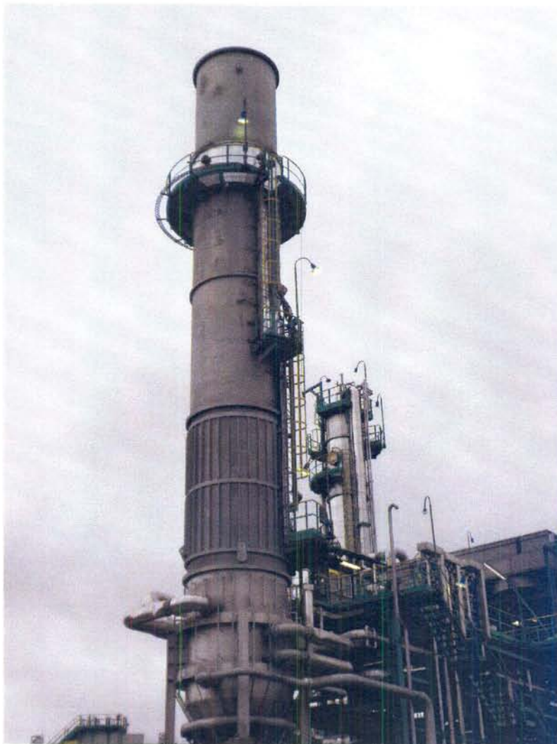
Camino del termodistruttore E020
