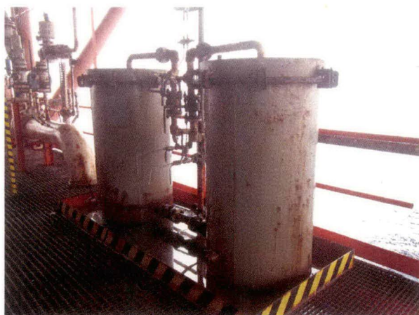
Foto 2 – Sistema di filtrazione a carboni attivi.
