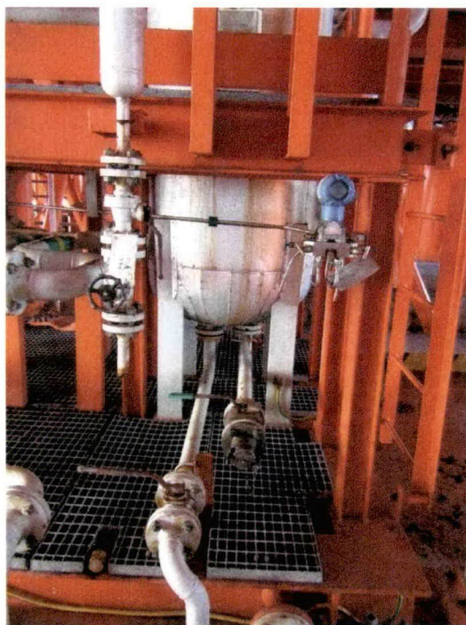
Foto 4 - Impianto di trattamento con filtri a carbone attivo
