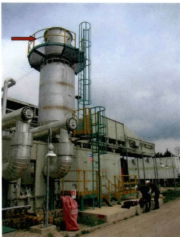
Foto 2: Punto di emissione E108
