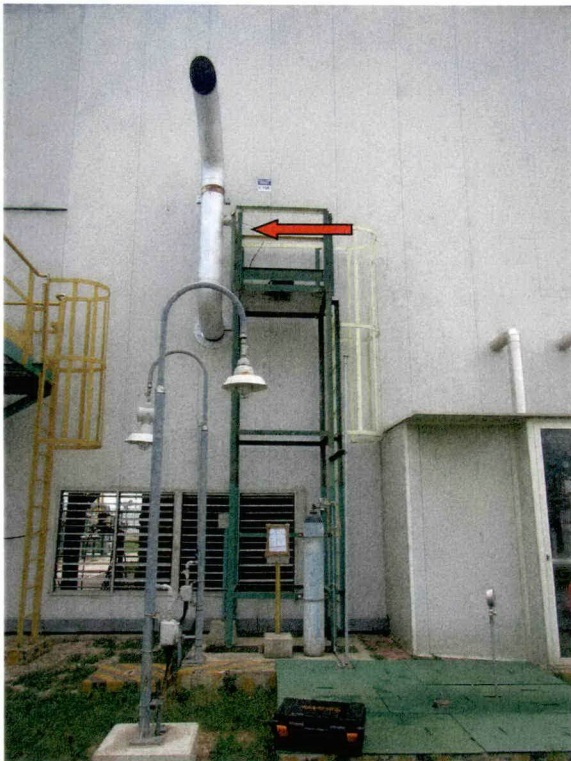
Foto 6: Punto di emissione E106
