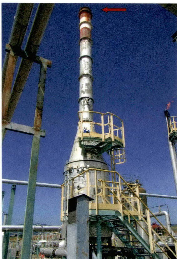
Foto 4: Punto di emissione E005
