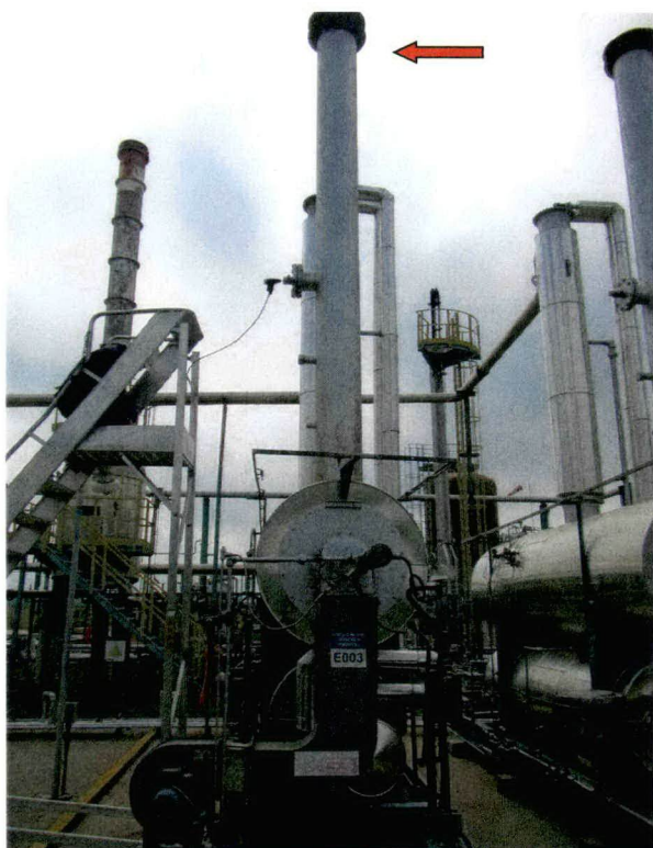
Foto 8: Punto di emissione E003
