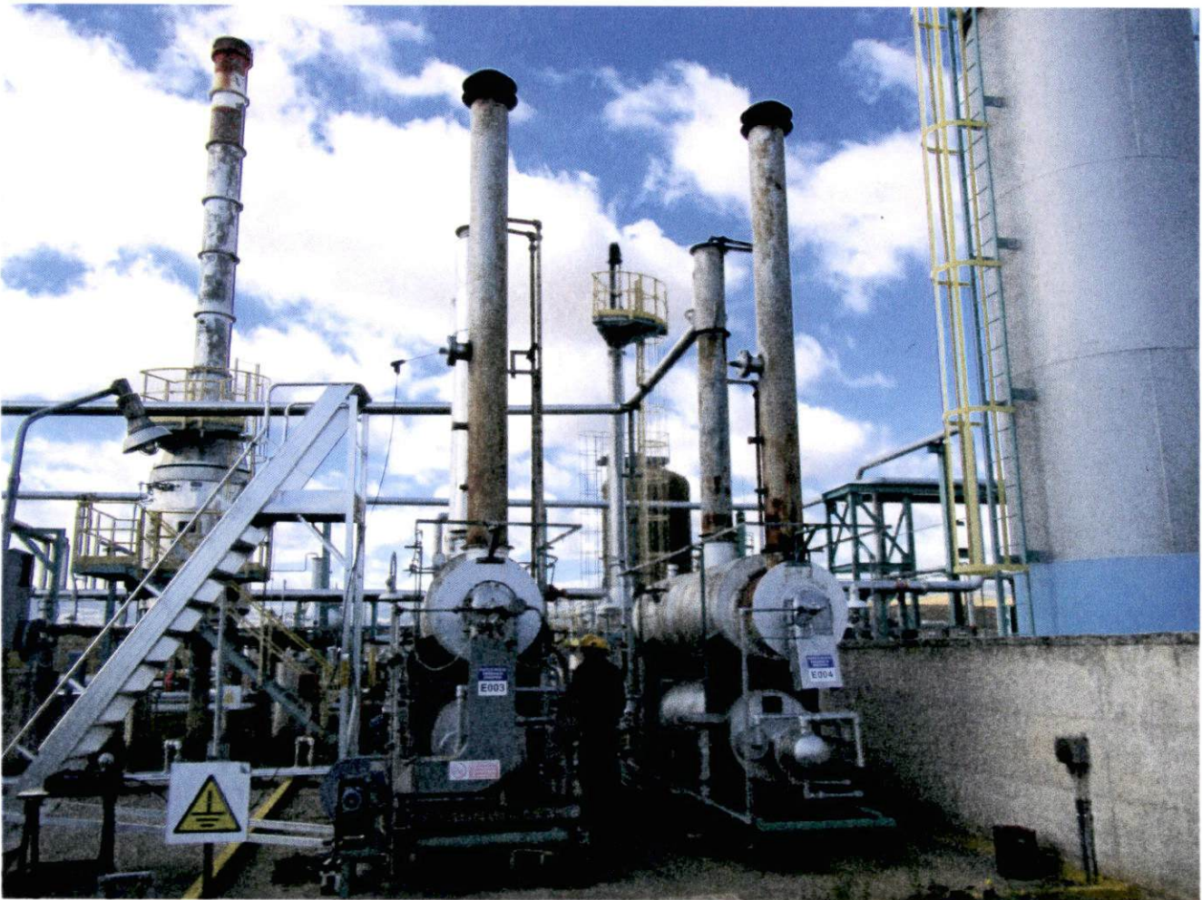
Centrale “Roseto”: Termodistruttore e Rigeneratori TEG
