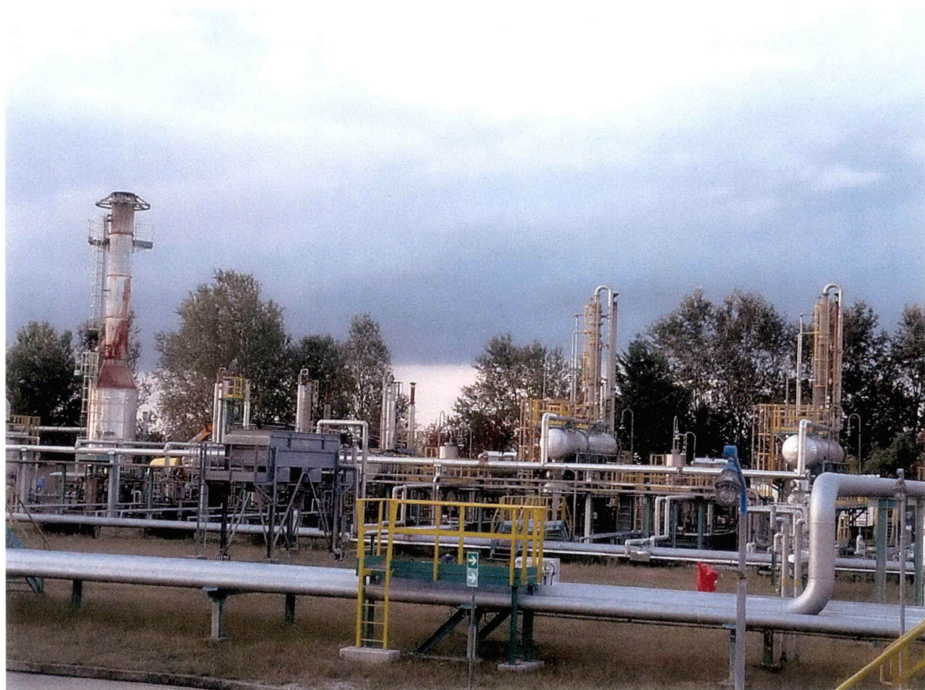
Centrale “Ravenna Mare”: Termodistruttore e Rigeneratori TEG
