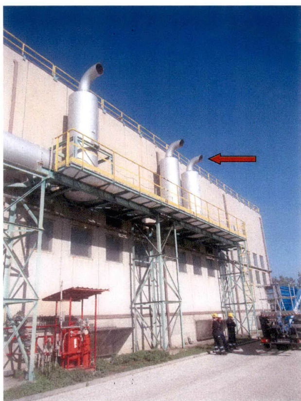
Foto 6: punto di emissione E13
