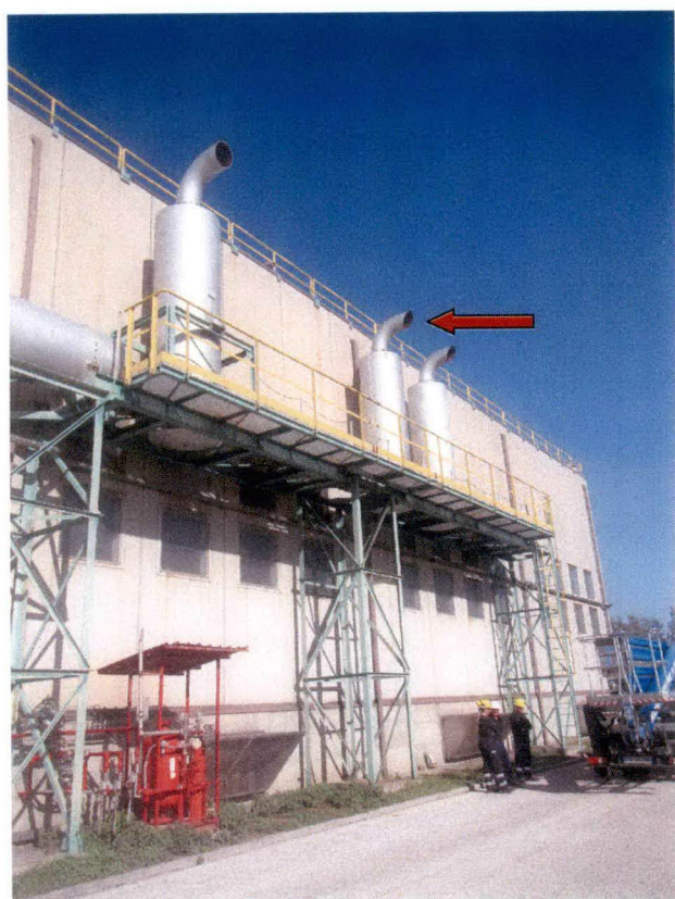
Foto 2: punto di emissione E14
