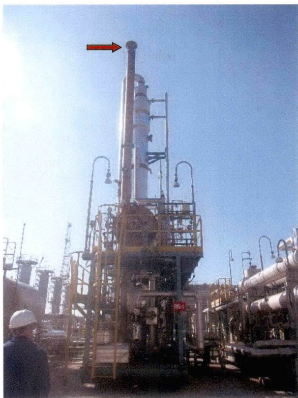
Foto 5: punto di emissione E25
