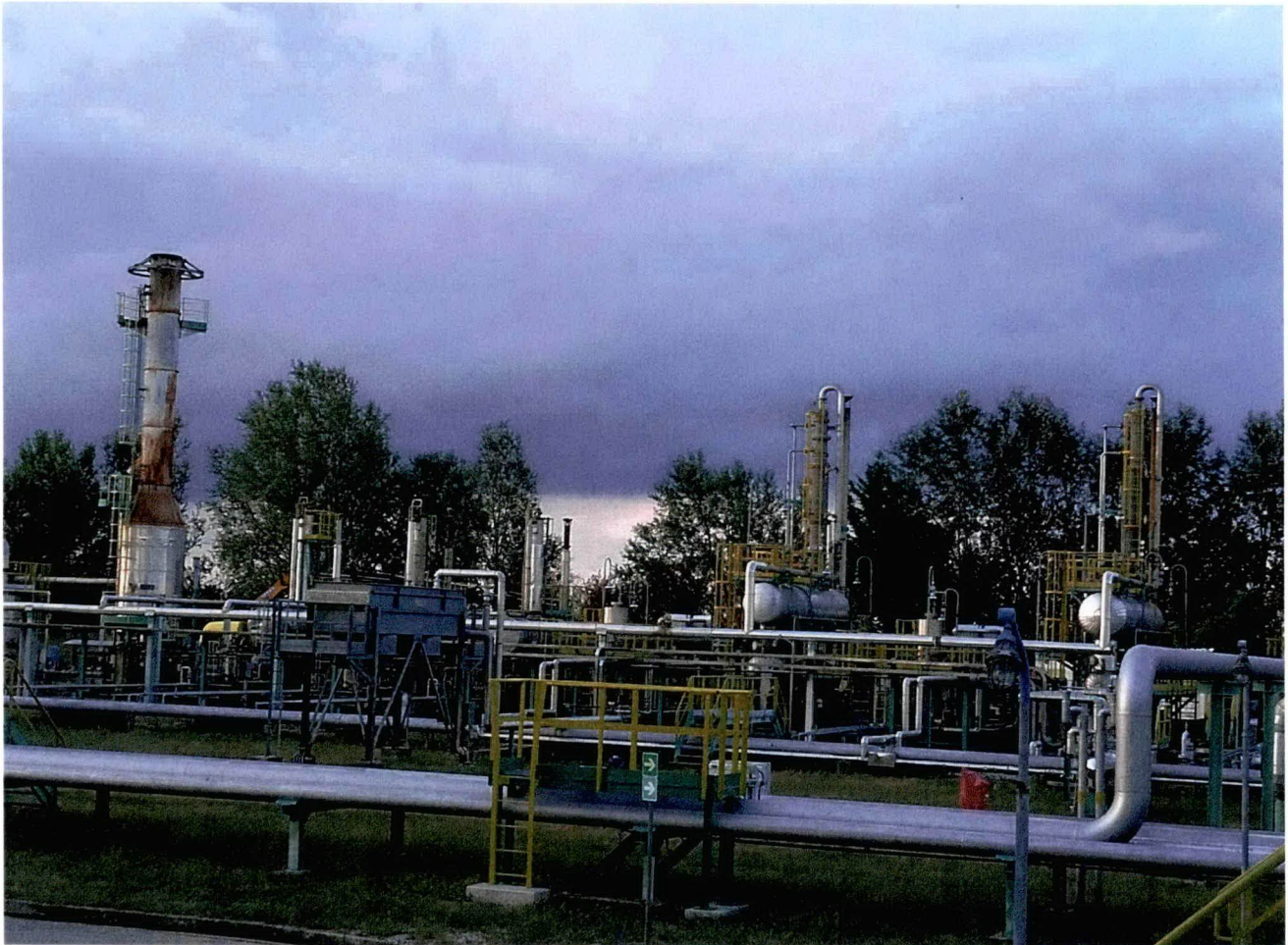
Centrale “Ravenna Mare”: Termodistruttore e Rigeneratori TEG
