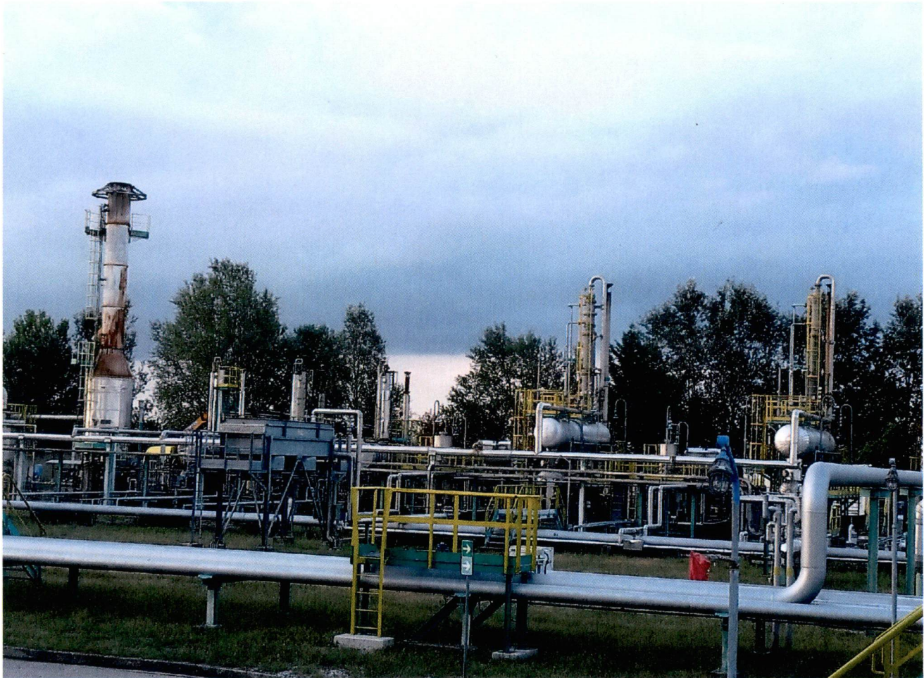
Centrale “Ravenna Mare”: Termodistruttore e Rigeneratori TEG
