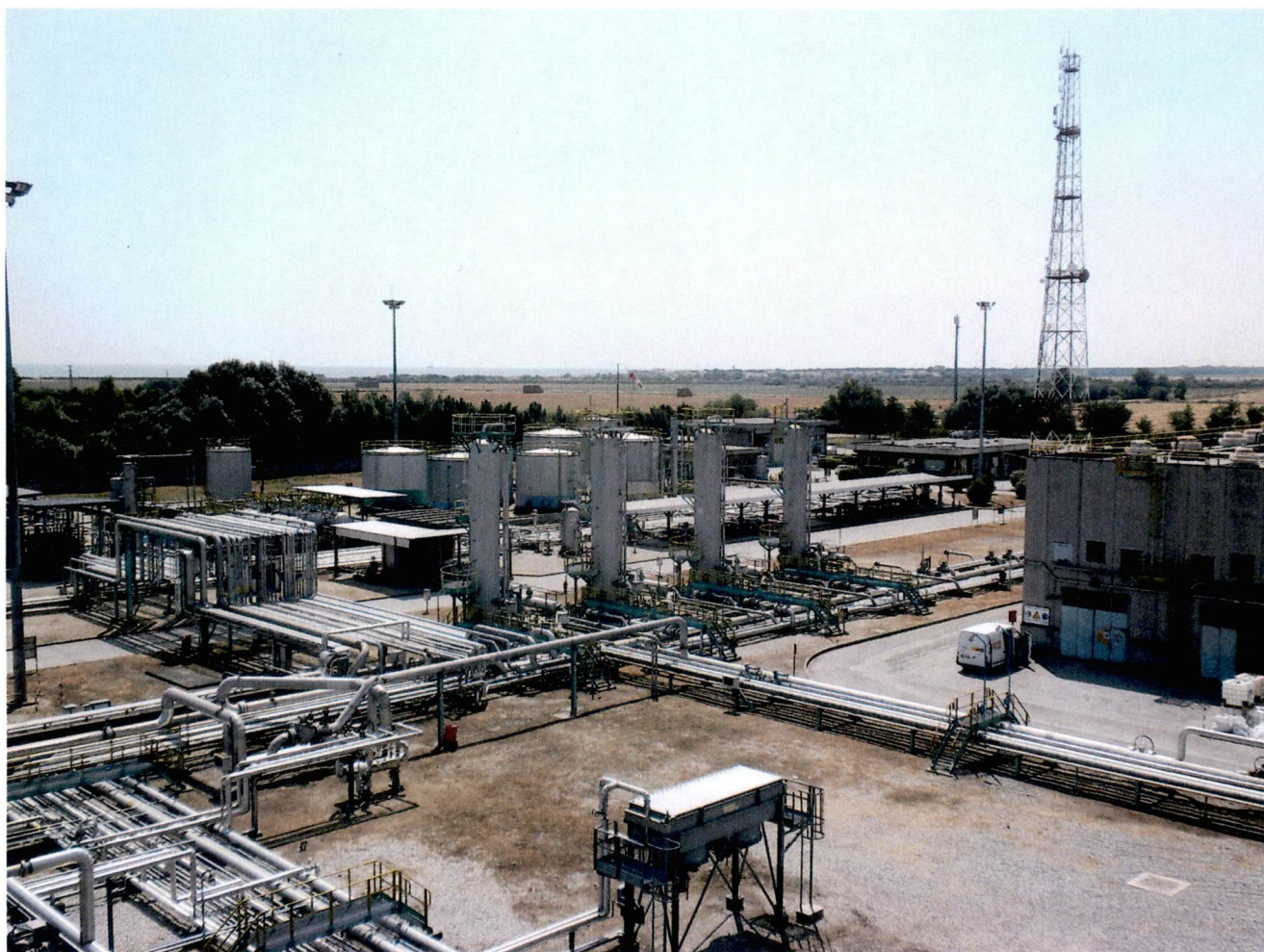
Centrale “Ravenna Mare”
