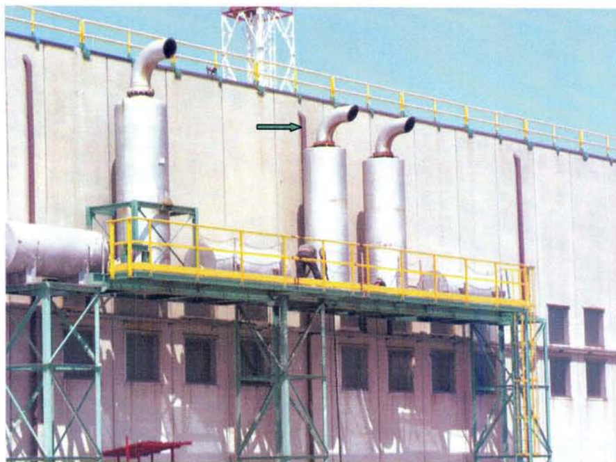
Foto 2: Punto di emissione E14 (camino indicato dalla freccia di colore verde)
