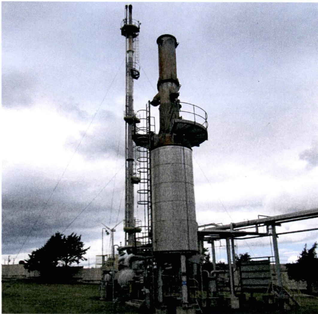
Centrale “Candela”: Termodistruttore C-102
