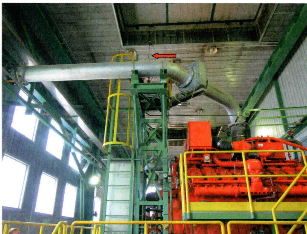
Motocompressore gas 360-MG-201 e punto di prelievo dei fumi (freccia rossa)
