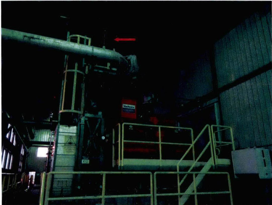
Motocompressore gas 360-MG-301 e punto di prelievo dei fumi (freccia rossa)
