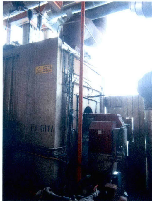
Foto 5 - Caldaia a gasolio FA101A
