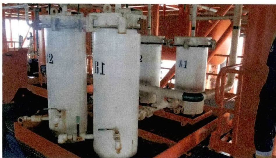
Foto 4 - Impianto di trattamento con filtri a carbone attivo
