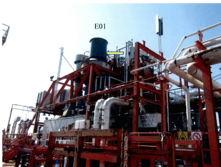
Foto 2 - Punto di emissione attivo E01 con l'indicazione, mediante freccia gialla, della flangia di prelievo.
