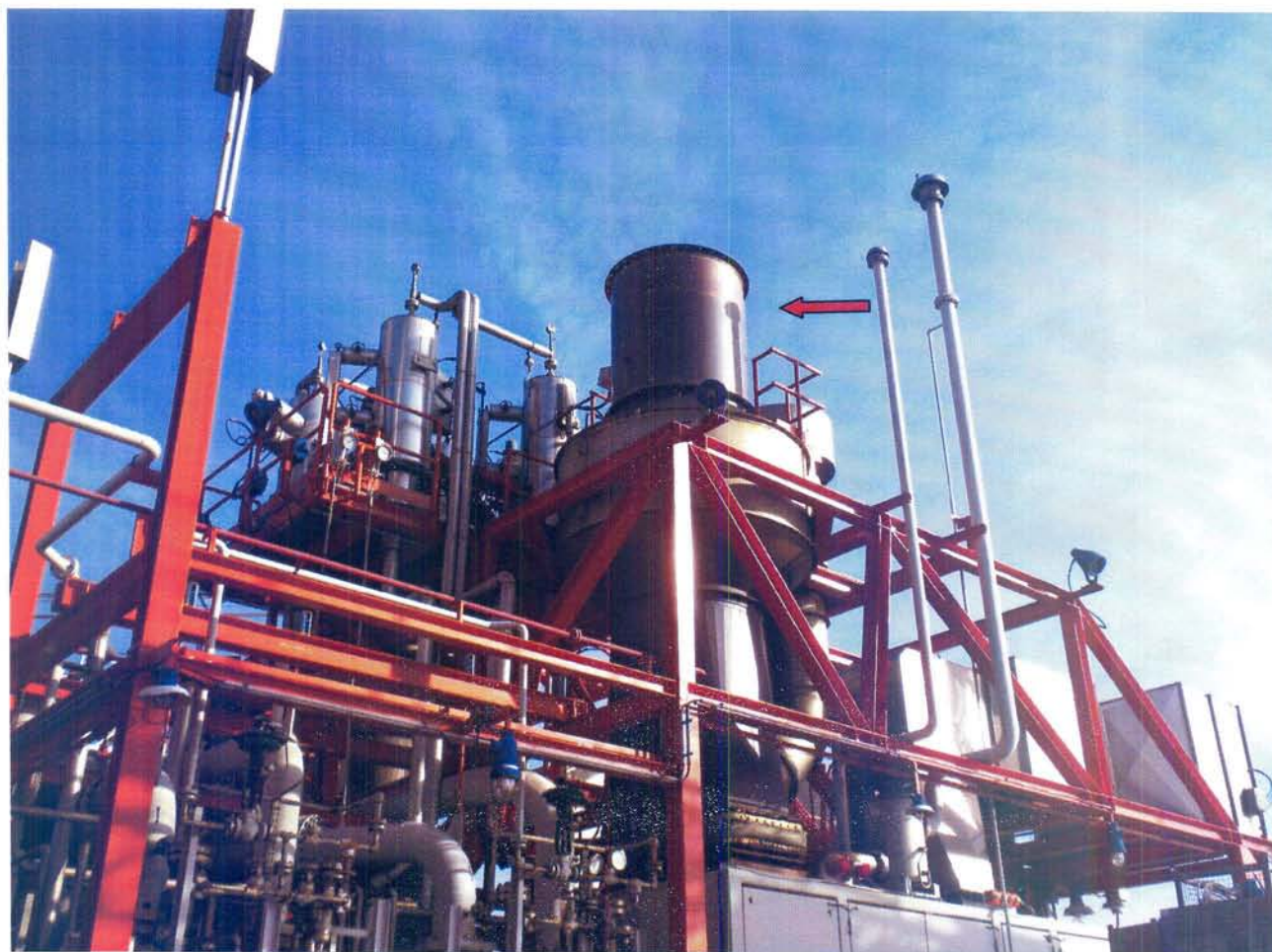
Camino E02 del turbocompressore TK-201 (freccia di colore rosso)
