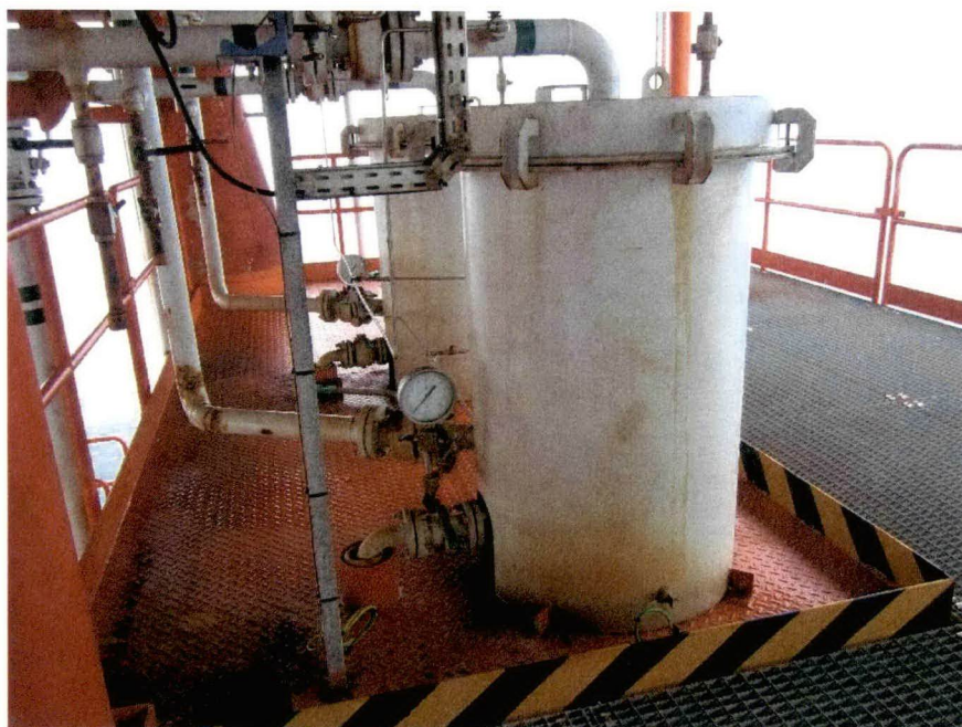
Foto 6 - Impianto di trattamento con filtri a carbone attivo
