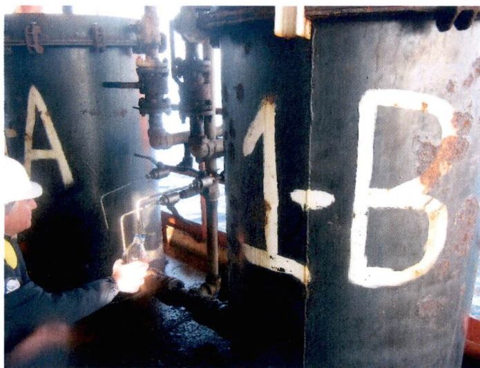
Foto 3 – Prelievo a valle del filtro a carbone attivo
