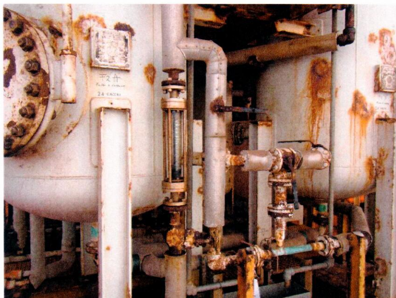
Foto 4 - Impianto di trattamento con filtri a carbone attivo
