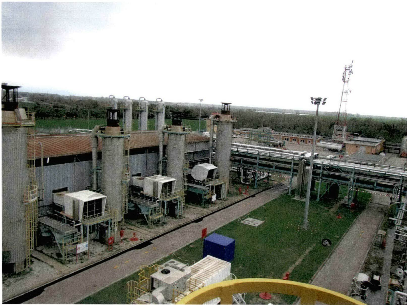
Centrale “Casalborsetti”: turbine di compressione gas Nuovo Pignone KA04, KA03, KA02 e KA01
