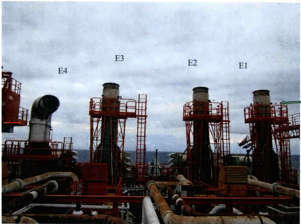
Foto 2: Punti di emissione attivi E1 ed E4, con l'indicazione, mediante freccia colorata, delle flange di prelievo.
